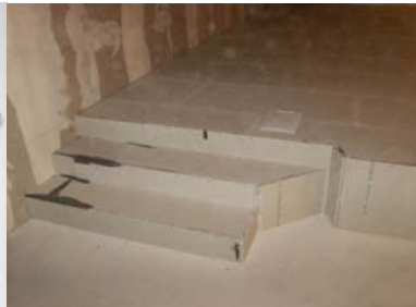
Hohlboden mit Treppe und Verkleidung
