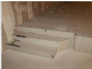
Hohlboden mit Treppe und Verkleidung
